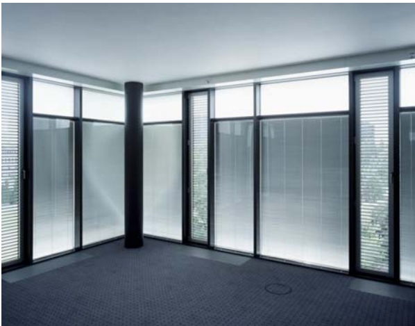
Bild 24: Fenster mit lichtlenkendem Glas im oberen Bereich (Lumitop) und Sonnen-/ Blendschutz im unteren Bereich (Jalousie im Scheibenzwischenraum) Sonnenschutz komplett geschlossen
